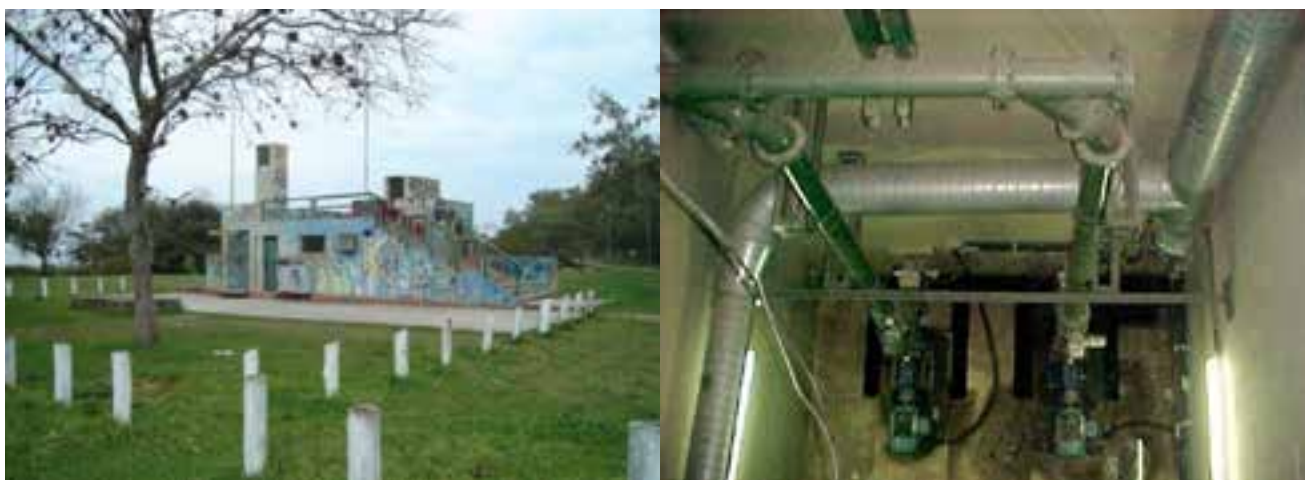
Figura 5.73 – EBE BN1 Belém Novo (Vista Externa e Interna)
