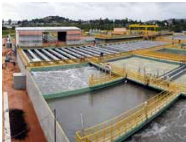
Figura 5.41 – Foto da ETE Serraria (em testes operacionais)
